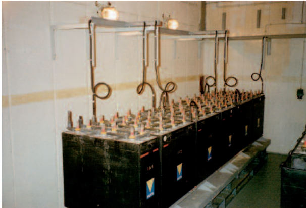
Aufnahme einer Trockenbatterie aus der baugleichen GSVBw21 in Lüdersen.
