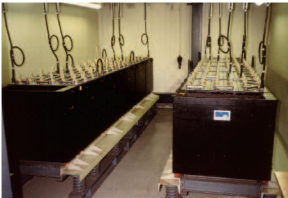
Von beeindruckender Größe waren die beiden Trockenbatterien in der Fernmeldeanlage, die als letzte Sicherung der Stromversorgung dienten (Aufnahme aus der GSVBw21).
