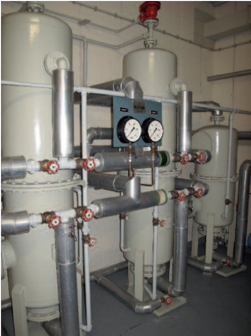
Druckbehälter der Brunnenanlage mit Kontrollinstrumenten [2014].
